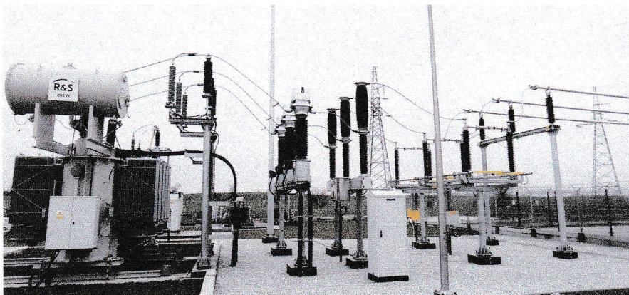
Rozdzielnia napowietrzna 110 kV GPO FW Rywałd
