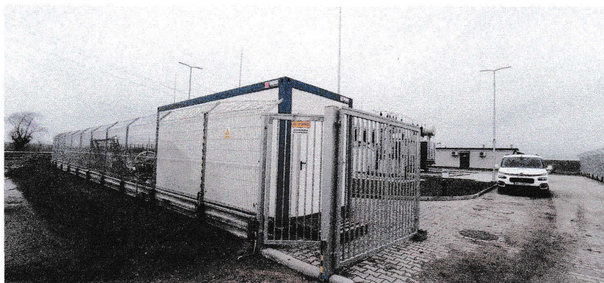
Stacja elektroenergetyczna 30/110 kV GPO FW Rywałd. Brama wjazdowa i ogrodzenie
